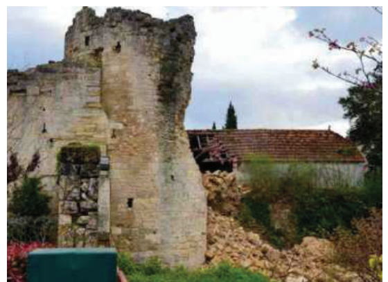
Une partie de la tour s'est effondrée sur un garage. PH. FRÉDÉRIC DUPLY
